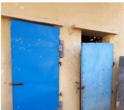
Deuren van bestaande toiletten. Zoals u ziet zijn deze stalen deuren in zeer slechte staat, ook hang- en sluitwerk functioneert niet goed meer
