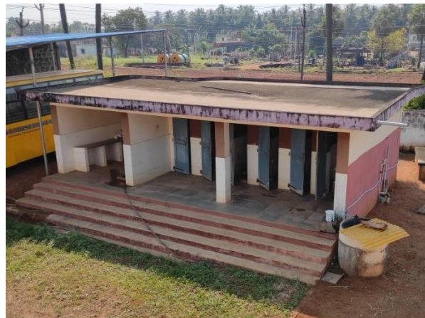
Het vervallen toiletgebouw
