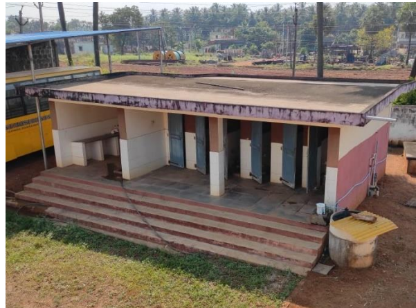
Het vervallen toiletgebouw
