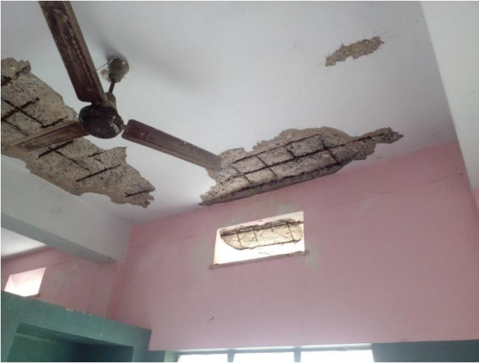
Te repareren plafonds
