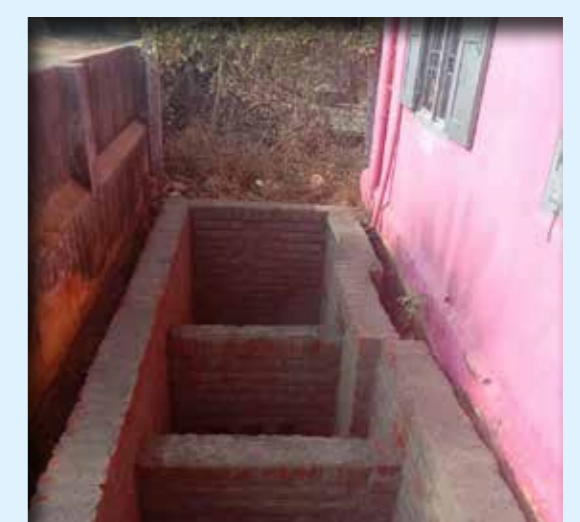
2018. ODDANTHANGAL. "zinkput" bij toiletgebouw.
