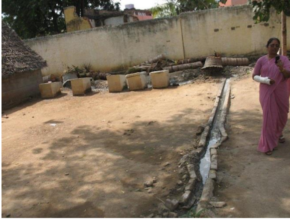
Jolarpet: het afvalwater loopt de tuin in, tot aan de wasstenen. Links achterin, op de plaats van de hut, kan de nieuwe zinkput komen
