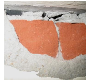
scheuren in toiletgebouw
